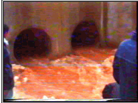
صورة (13): صرف عبارة وادي الكوف، شرق جسر الكوف، عند مخرجها بلغ 1387 ل/ثا، أي أن التصريف هنا ينقص بمقدار 1525 ل/ثا عن تصريف محطة الغريقة، بما يعادل 52.37%، هذه المركبة الأخيرة تضيع في الوادي عن طريق الرشح بمعدل 72.62 ل/كم طولي من مجرى الوادي، دون الأخذ بالحسبان المياه التي ترصد الوادي من جوانبه الصخرية على مسافة 21 كم بين محطتي القياس، مع العلم أن هذه المياه ذاهبة لتضيع في البحر في جرجار أمه، الجمعة 27.03.1998، الساعة 11:45.
