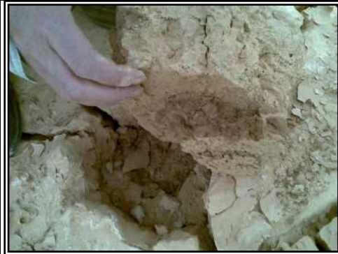
صورة (82): أرضية القض الجنوبي من السيلنت والطين في بلطة الرملة، التربة تحوي رطوبة من الأمطار المحلية لذلك لا تظهر فقاعات المسامية، الجمعة 30.03.20012
