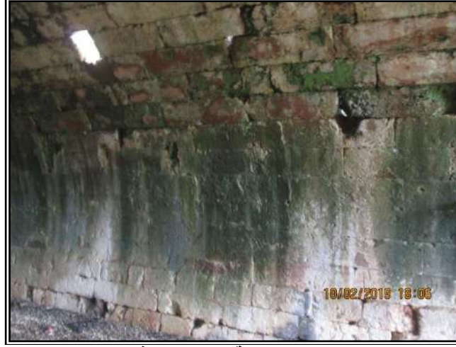
صورة (133): الجدار الشمالي الملاصق للتربة يظهر عليه فعل رشح المياه الجوفية من التربة المجاورة للجدار الشمالي للخزان الشمالي من المنظومة إلى داخل الخزان عبر حجارة هذا الجدار، لاحظ الفرق بين فعل الرشح عند مناسيب الأكتاف الخارجية للجدار في الأعلى وأسفل منسوب التربة المجاورة للجدار في الأسفل، شحات، الأحد 10.02.2019، الساعة 18:06.
