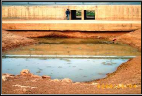
صورة (46): صورة لبيئة النحت أسفل إحدى العبارات الثلاث تحت طريق مشروع سلك الحريقة المتفرع من وادي الرمل في المخيلي، المياه تجمعت من جريان 14 و 15/10/2008، تاريخ الصورة، الخميس 04.12.2008.
