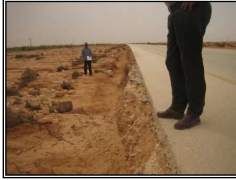
صورة (38): تدمير الجانب الجنوبي لطريق المخيلي - الخروبة بسبب فيضان مياه وادي الثعبان على الجانب الشمالي من الطريق، الأحد 21.10.2007
