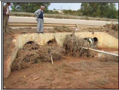
صورة (31): نموذج لانسداد العبارات بالنفايات النباتية أسفل قندولة وفيضان المياه فوق الطريق وتخریب الأراضي الزراعية، الجمعة 19.10.2007.
