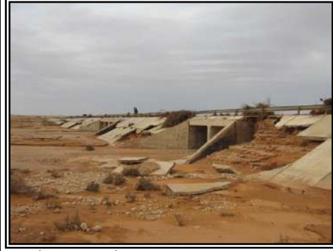
صورة (37): تخريب الحماية الخرسانية لجوانب الطريق بسبب الانسداد الجزئي أو الكلي للعبارات وتعدى المياه على جسم الطريق وسقوطها على هيئة شلالات على الجانب الجنوبي من الطريق في بيئة السروال في وادي الحمامة، الفتحة الإجمالية للعبارة 4م × 3م 6 × فتحات، تفيض مياه السيول أحيانا على الطريق العام لمسافة تزيد عن 500 م وتؤدي لقطع حركة المرور كما يفيد بعض الإخوة (السنوسي جاد الله)، الجمعة 19.10.2007.
