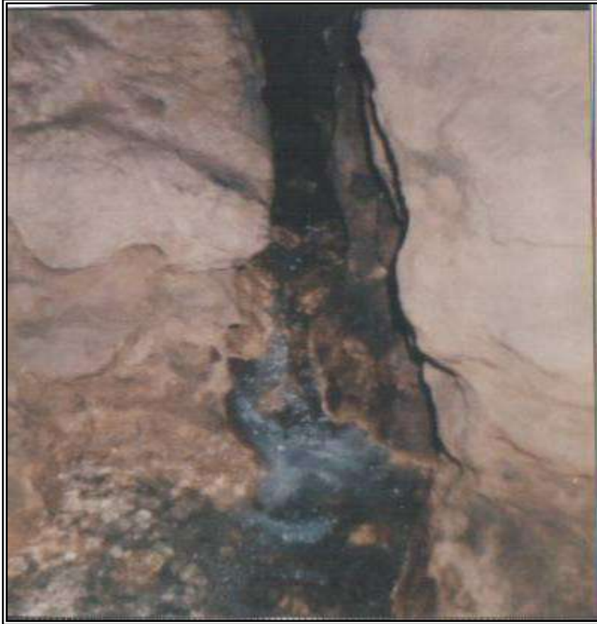
صورة (1): إحدى العيون الجانبية بنفق بو منصور بوادي درنه، العين تخرج من صدع عرضه حوالي 15 سم محشو بمواد التربة التي تجلبها المياه والجاذبية الأرضية من سطح الأرض بفعل الحركة الرأسية للمياه نحو الأسفل، السبت 14.03.1998.
