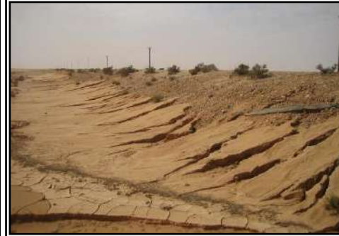
صورة (41): أثر تجاوز مياه الجريان من الشمال للجنوب لجسم طريق المخيلي- الخروبة، السروال، وادي الحمامة، الأحد 21.10.2007
