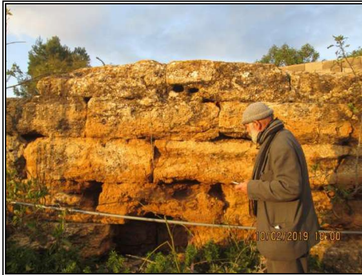
صورة (126): فعالية التجوية الكيميائية على الأسطح الداخلية لأحجار جدار الخزان الكبير الشمالي المكشوف، بفعل المياه الراشحة والمحملة بكربونات وأكاسيد الحديد من التربة والصخور المجاورة للجدار من جهة الشمال بما يكسبه هذا اللون البني المحمر، مدينة شحات، الأحد 10.02.2019، الساعة 18:00.
