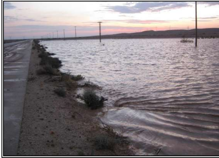
صورة (17): واحدة من عشرات البرك التي تتكون على يمين طريق المخيلي-الخروبة وتفيض مياهها على الطريق لعدم استيعاب العبارات لمياه سيول الأودية الصغيرة الغزيرة في غرب المخيلي، وادي محلي صغير بين وادي القوس ووادي بالعطر، الساعة 19:25، يوم الاثنين 09.06.2014.
