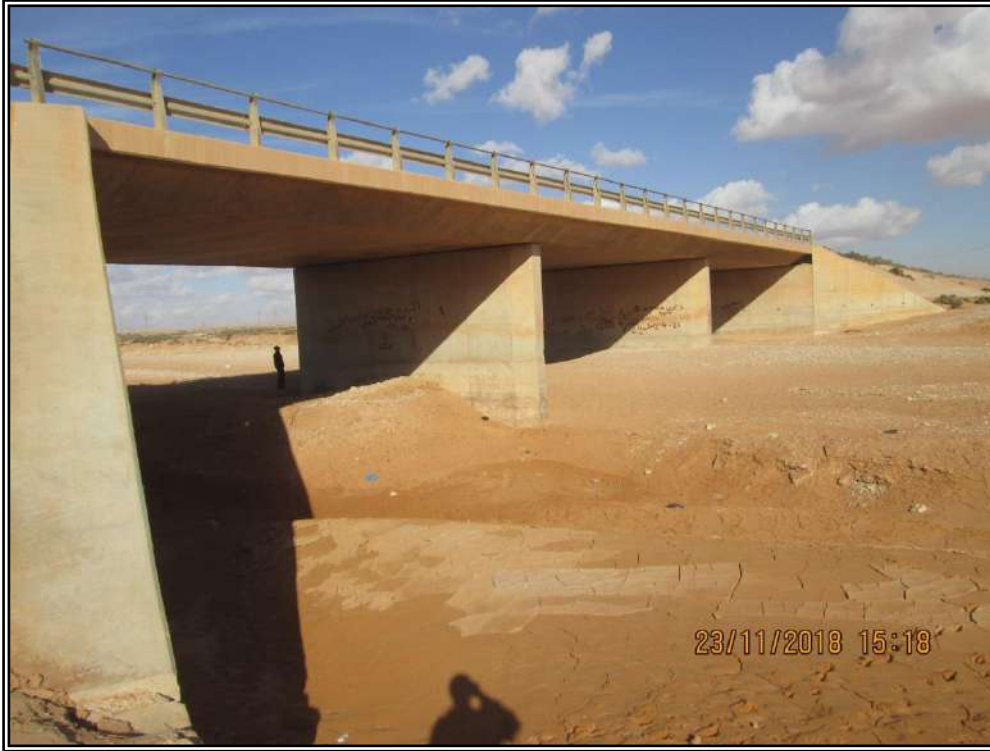
صورة (145): هذه هي عبارة المخيلي التي لم تستوعب مياه فيضان سيل وادي الرملية في ظهيرة الخميس الموافق 27.09.2018، قارن ، ارتفاع سقف العبارة بالنسبة لطول خليفة أمراجع الواقف تحت سقف العبارة، فكم كانت غزارة الجريان إذن؟!، مخرج مياه سيول وادي الرملية من عبارة المخيلي، الجمعة، 23.11.2018، الساعة 15:18.
